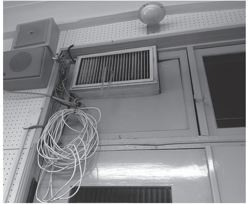
会議室ドア上部に無理矢理取り付けられた空調設備
